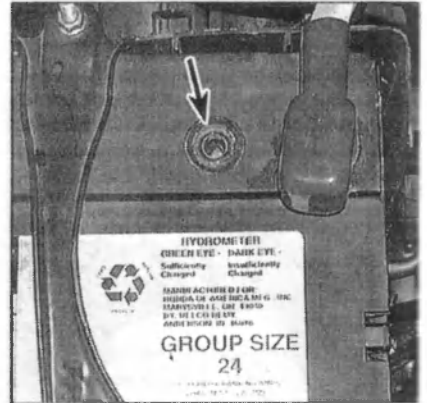
11.16 Батареи герметичного типа оборудованы индикатором уровня заряда - на корпус батареи наклеен ярлык с картой состояний индикаторного пятна
