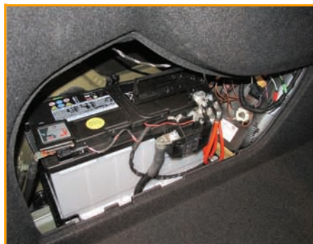
АКБ 12 В с главным блоком предохранителей в багажном отсеке
